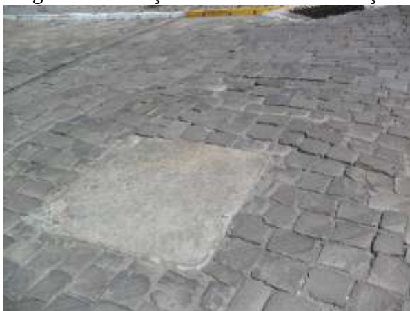
Figura 105 - Poço de vistoria e manutenção
