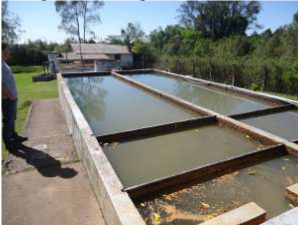
Figura 51 - Vista gerado do decantador
