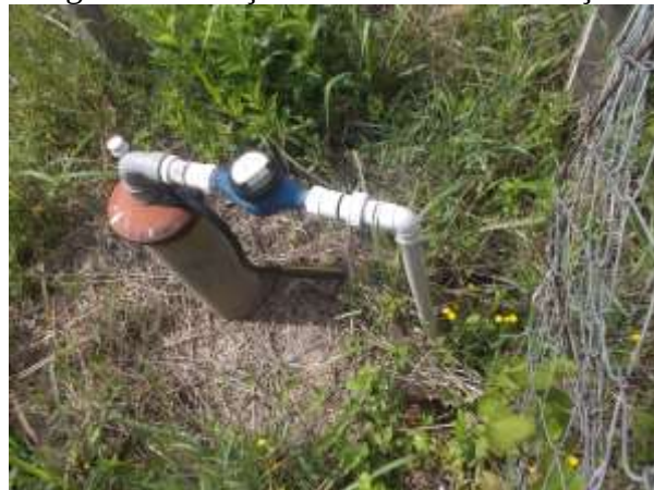
Figura 59 – Poço com sistema de medição
