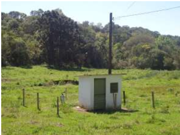
Figura 58 - Proteção e isolamento do poço subterrâneo conforme normas técnicas
