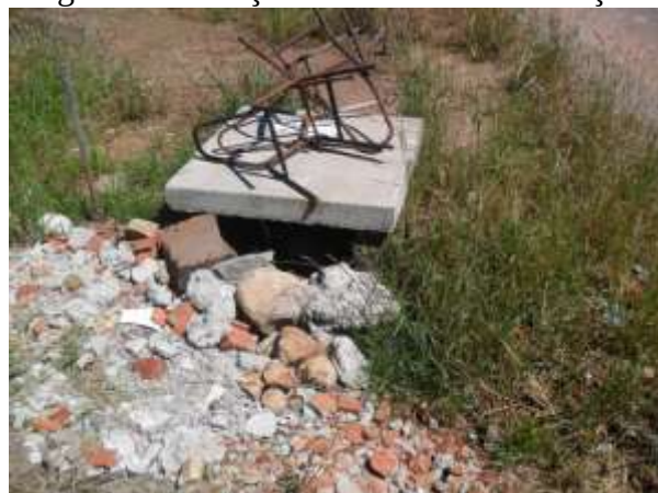
Figura 106 - Poço de vistoria e manutenção
