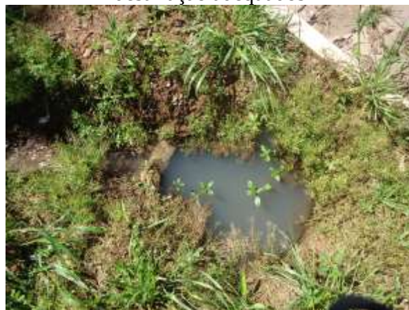
Figura 70 - Esgoto sem tratamento e destinação adequados
