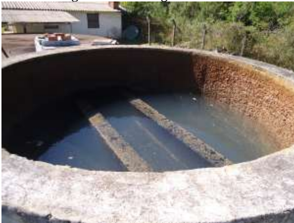
Figura 52 - Vista geral do filtro
