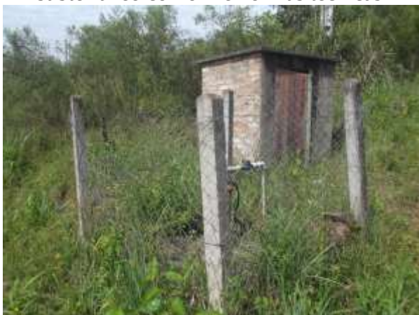
Figura 60 - Proteção e isolamento do poço subterrâneo conforme normas técnicas
