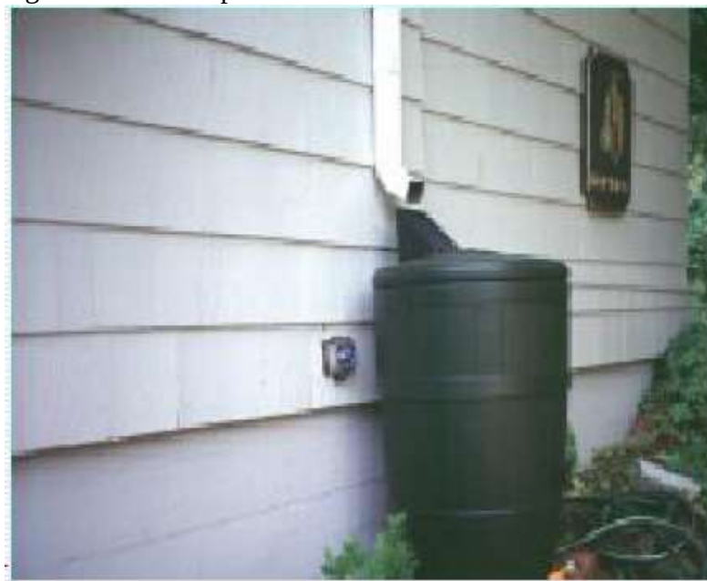
Figura 130 - Exemplo de cisterna instalada em uma residência
