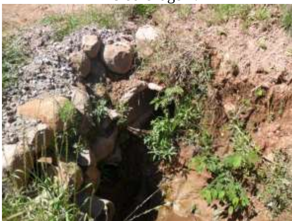
Figura 103 - Tubulações de concreto (0,40 e 0,30 m) que compõe o sistema de microdrenagem.
