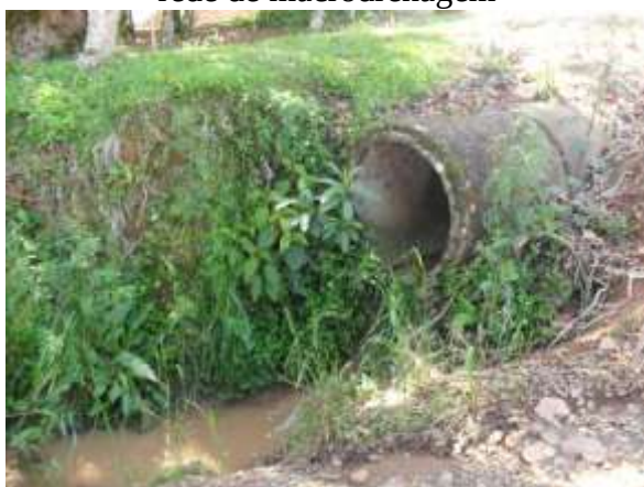
Figura 113 - Tubulação (0,60 m) que compõe a rede de macro drenagem
