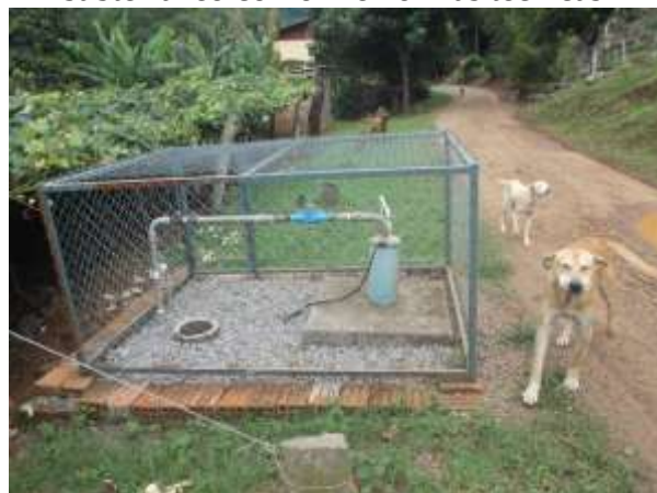
Figura 61 - Proteção e isolamento do poço subterrâneo conforme normas técnicas
