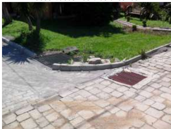
Figura 108 - Sarjetas e bocas de lobo observadas nas vias urbanas
