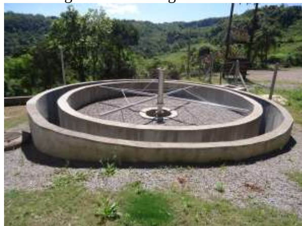
Figura 67 – Vista geral do filtro
